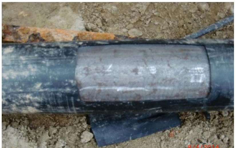
Bild oben: Erster Eindruck während des Abisolierens, in Vorbereitung der Messung einer unterirdischen Rohrleitung
