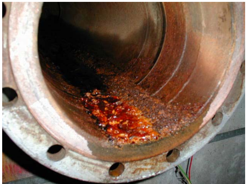
Im Produkt mitgeführte Sedimente können sich als Brücke über dem Isolierflansch ablagern und damit den kathodischen Schutzstrom der Rohrleitungen beeinflussen.
